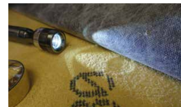
Die darunterliegende Holzfaserverplatte hat nach Beschuss mit 50 mm Hagelkörnern eine ca. 4 mm tiefe Delle.
